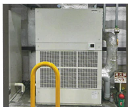
低温倉庫空調機
